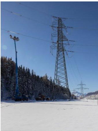
Infrastructure de réseau
