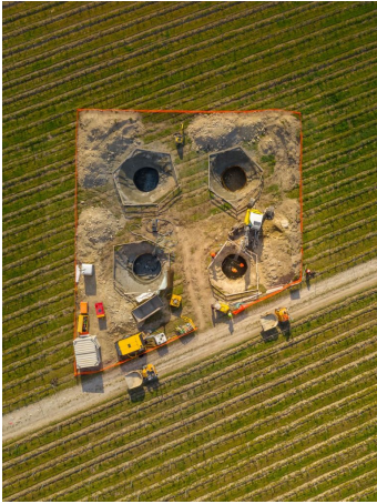
Infrastructure de réseau
