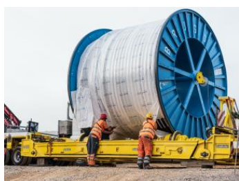
Infrastructure de réseau
