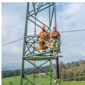
Infrastructure de réseau
