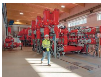
Infrastructure de réseau
