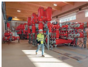
Infrastructure de réseau
