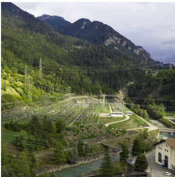
Infrastructure de réseau
