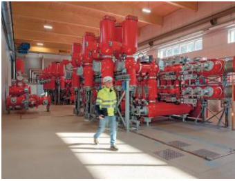
Infrastructure de réseau
