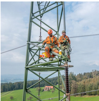
Infrastructure de réseau
