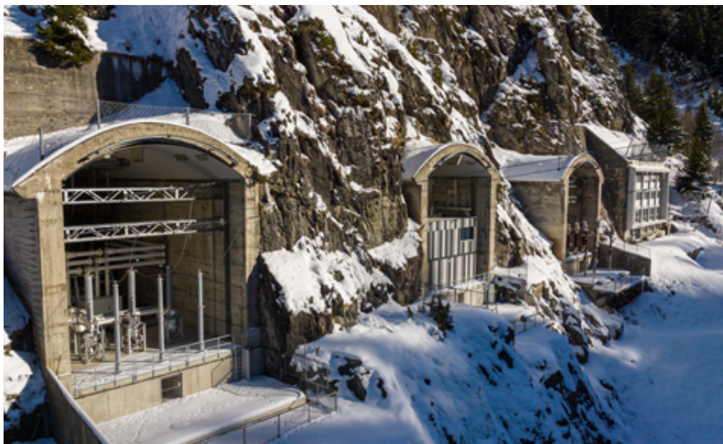
Swissgrid Unterwerk Fionnay GD im Wallis
