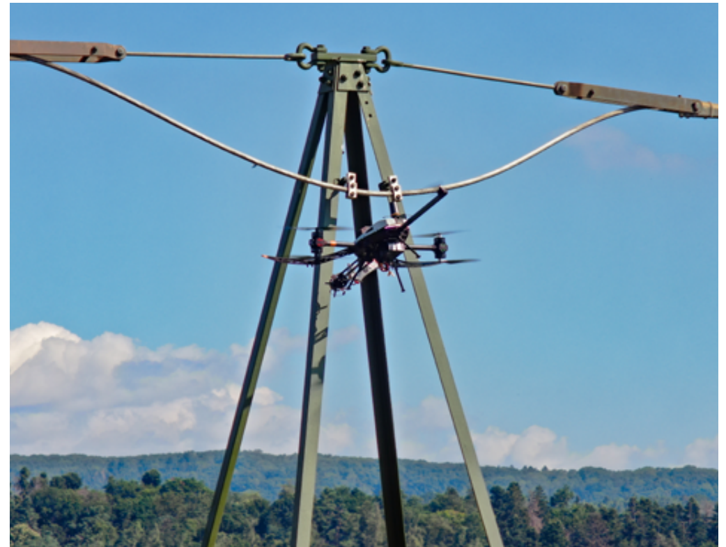
Korrosionsanalysen mit Drohnen sind schneller, standardisiert und sicherer
