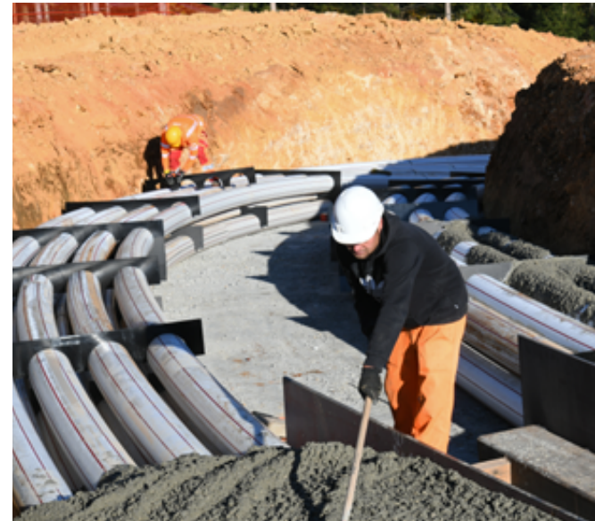
Beispiel einer Verkabelung im Kabelrohrblock
