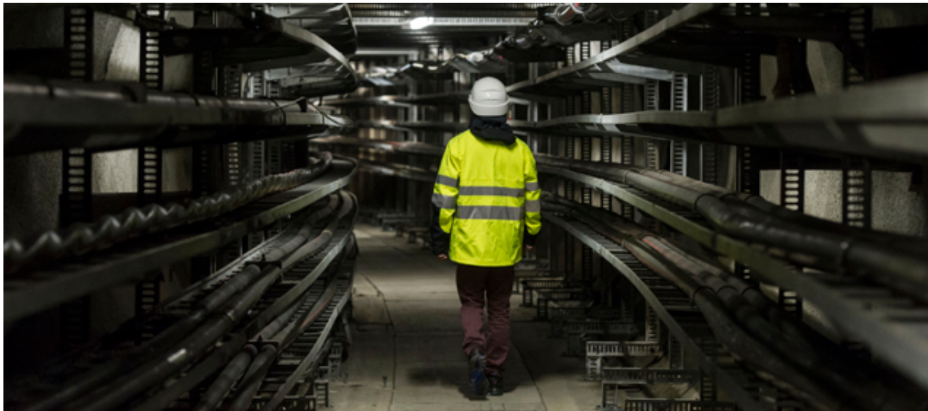
Beispiel einer Verkabelung im Tunnel
